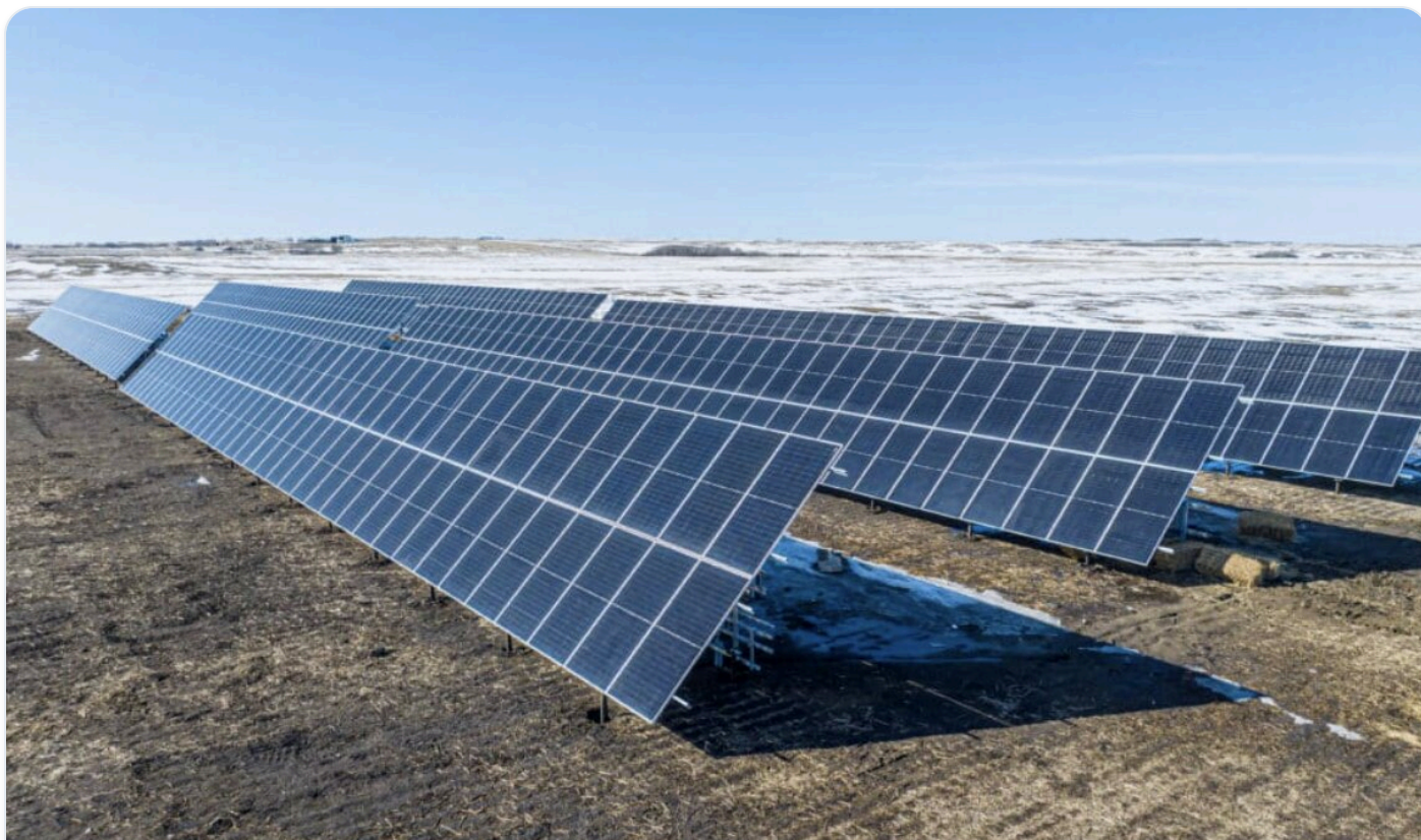
Champ solaire au sol
