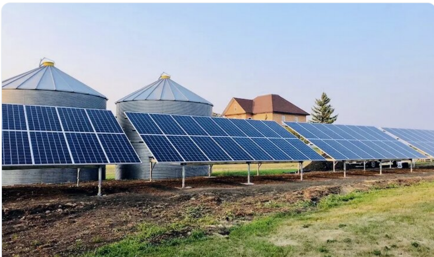
Ferme céréalière — champ solaire au sol
