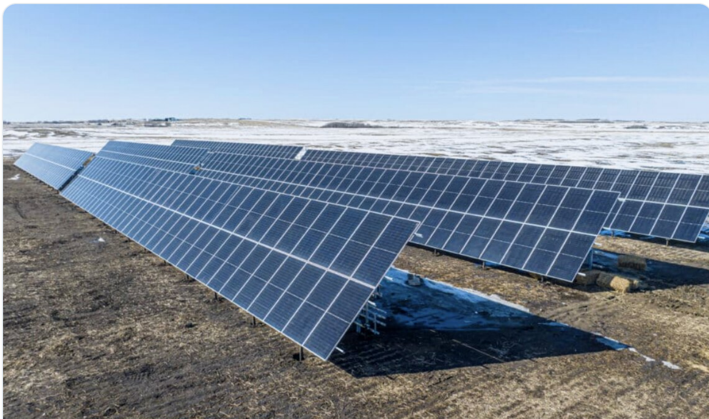
Champ solaire au sol
