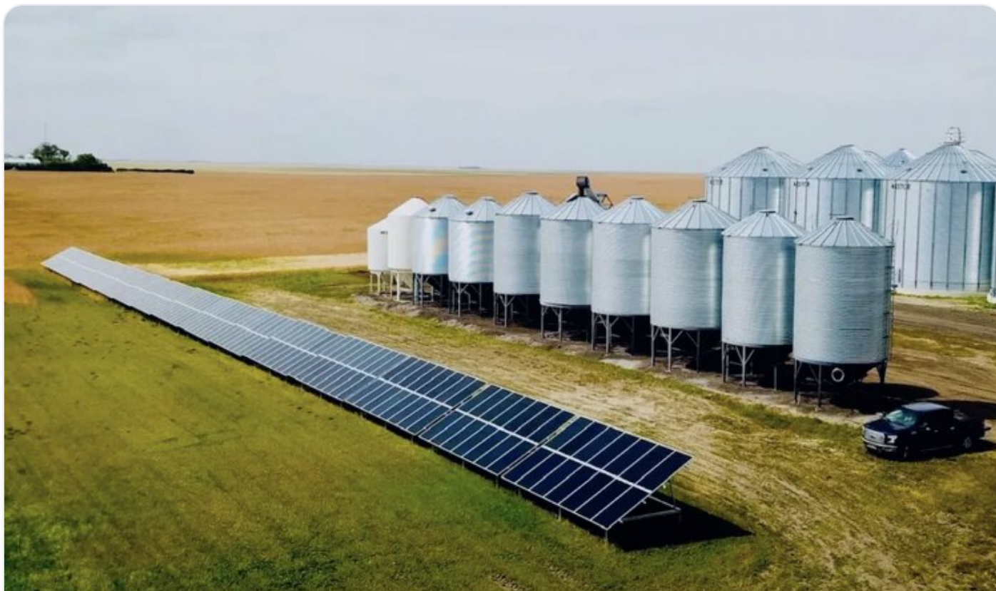
Ferme céréalière — champ solaire au sol
