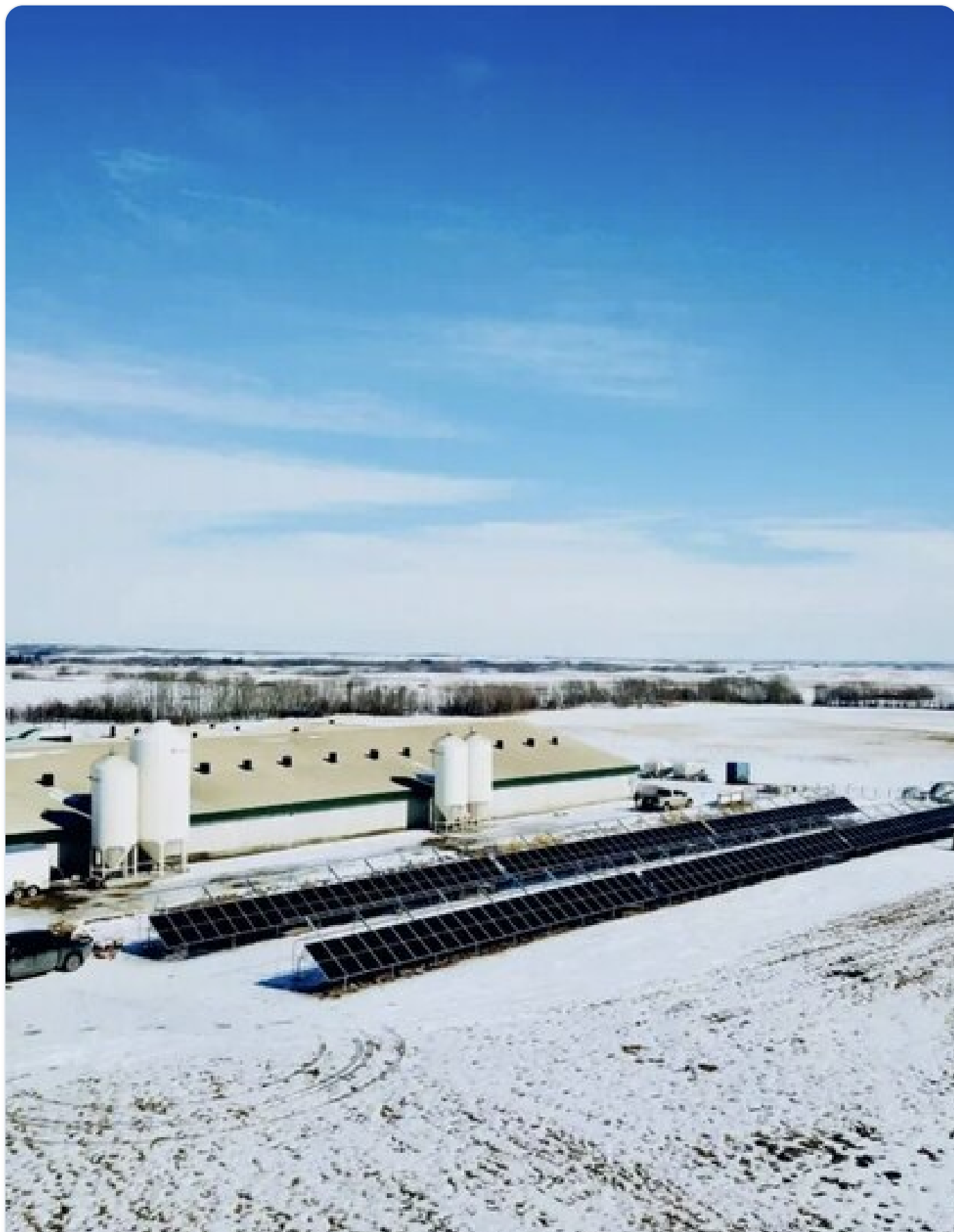
Étable d'élevage — solaire au sol
